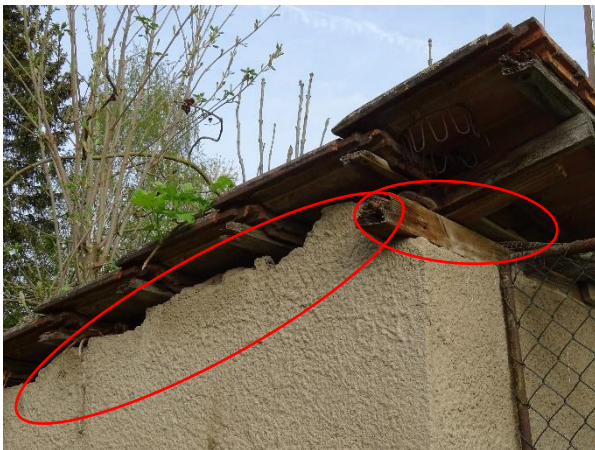
Abb. 8: Nischen und Schadstellen (rote Markierungen) im Traufbereich des Taubenstalls
